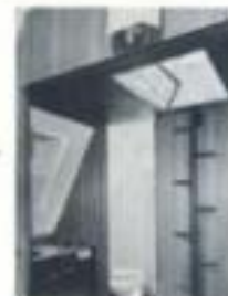
Un particolare: l'angolo tra la parete e il soffitto
